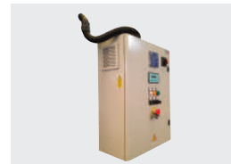
Cuadro eléctrico ( sólo 4-6 ) Cuadro electrico con variador de frecuencia
