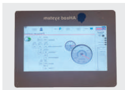
Cuadro electrico con sistema AHEAD BASE
